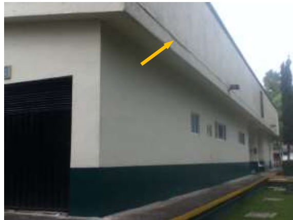
Foto 6. Fisura en la junta entre el faldón perimetral y la losa de cubierta. No es daño estructural, sólo estético.
