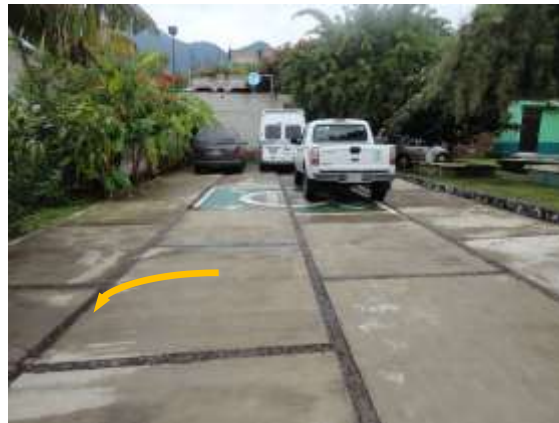
Foto 6. Asentamiento del piso del estacionamiento.
