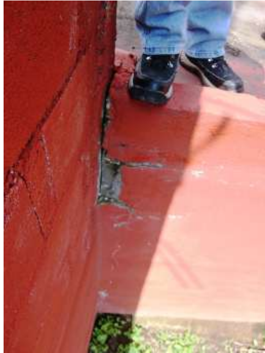
Foto 7. Separación de muro por falta de castillo y cadena de confinamiento
