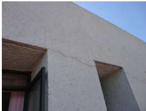
Foto 5. Fisura en aplanado de junta de cajillo
