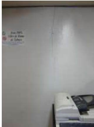
Foto 4. Fisura en aplanado de junta de cajillo
