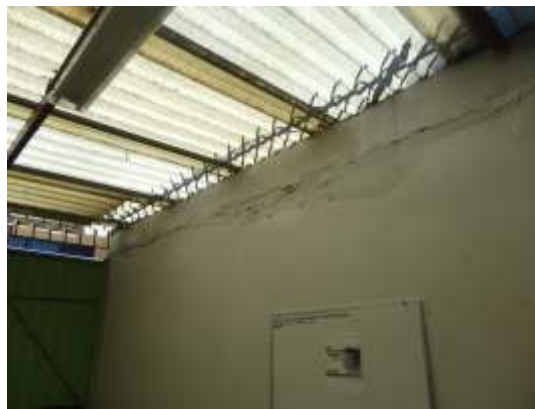
Foto 4. Fisura en junta fría
