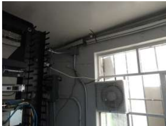
Foto 5. Fisura en aplanado de muro
