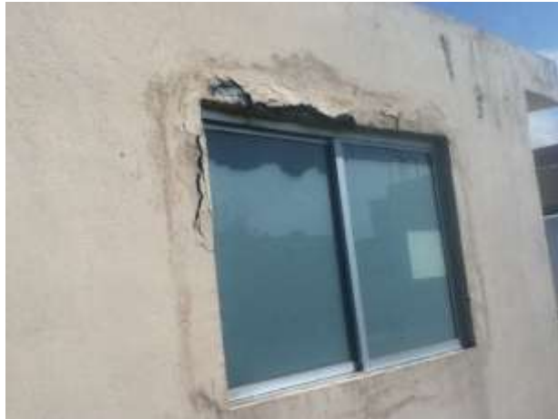
Foto 7. La ventana no tiene confinamiento adecuado.
