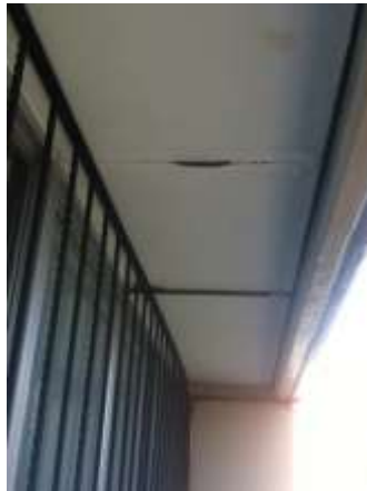
Foto 6. Fisura en plafond de tablaroca
