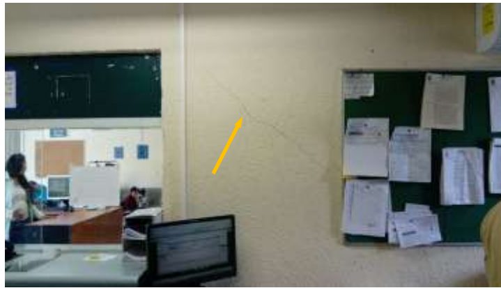
Foto 4. Fisura en aplanado de muros, debido a asentamiento.
