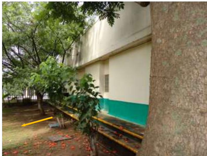
Foto 5. Asentamiento en el ala sur, debido a socavación del subsuelo.
