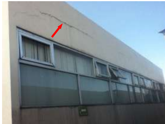
Foto 7. Fisura en junta constructiva
