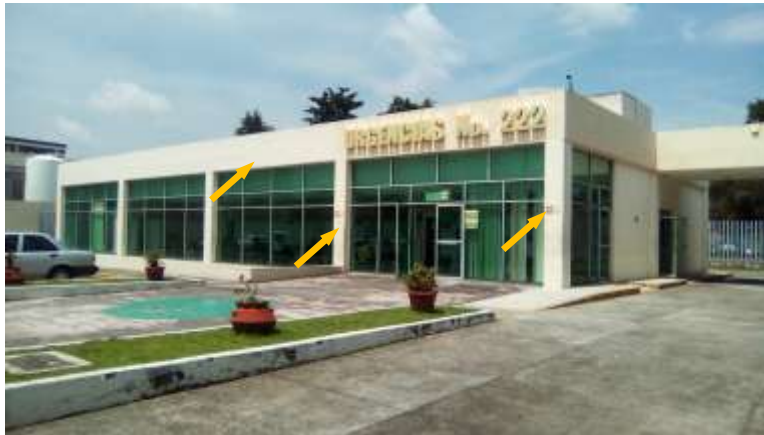
Foto 4. Vista de Columnas y Trabes de concreto reforzado del edificio de URGENCIAS de la (UMF) No. 222
