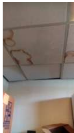
Foto 6. Daño en plafones debido a presencia de humedad. No pone en riesgo la estabilidad del edificio.
