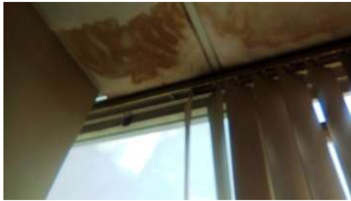
Foto 5. Plafond maltratado debido al paso de agua de lluvia por el cancel perimetral
