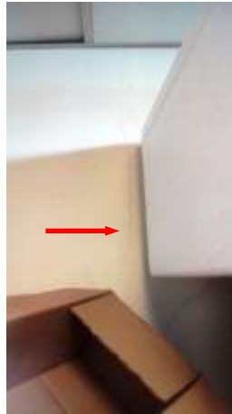
Foto 5. Fisura en acabado de muro perimetral. No pone en riesgo la estabilidad del edificio.
