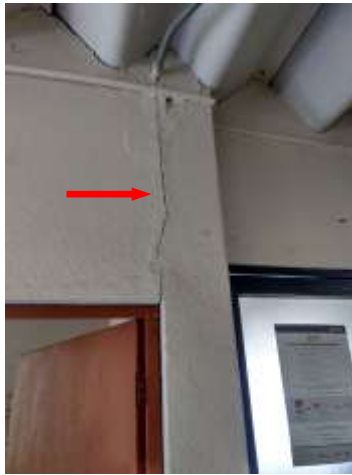
Foto 5. Fisura en junta constructiva mal detallada.
