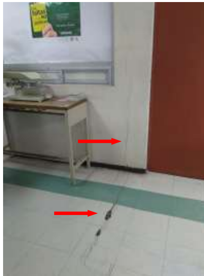
Foto 6. Fisura en junta constructiva.
