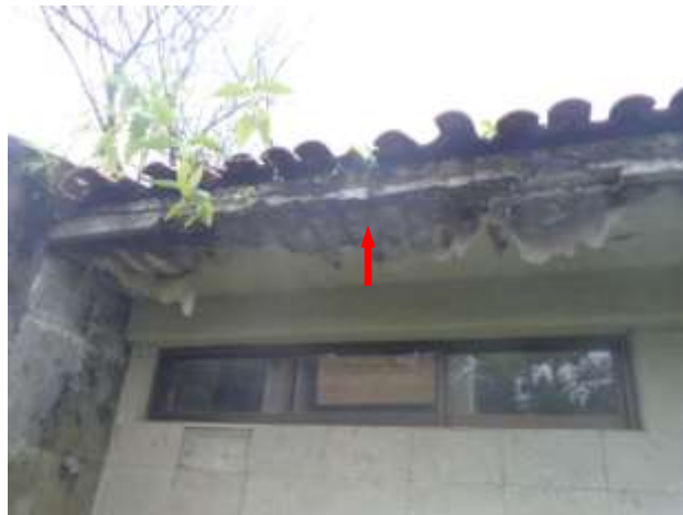
Foto 5. Deterioro del recubrimiento de la losa perimetral.
