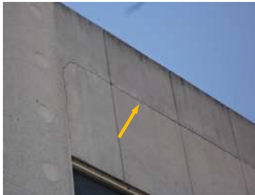
Foto 4. Fisura en junta de aplanado de faldones de durock. No tiene implicación estructural.
