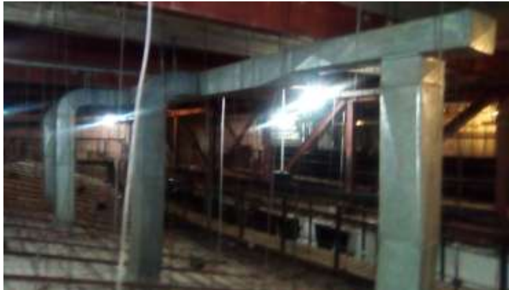
Foto 4. Vista del plafond, sistema de aire acondicionado y cubierta del Teatro. No hay daño alguno.
