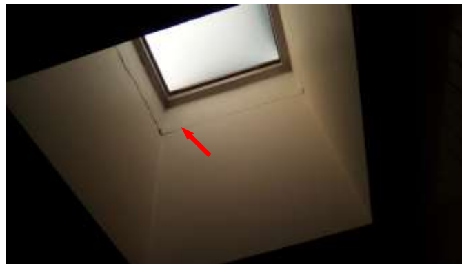
Foto 5. Fisura en cajillo de domo
