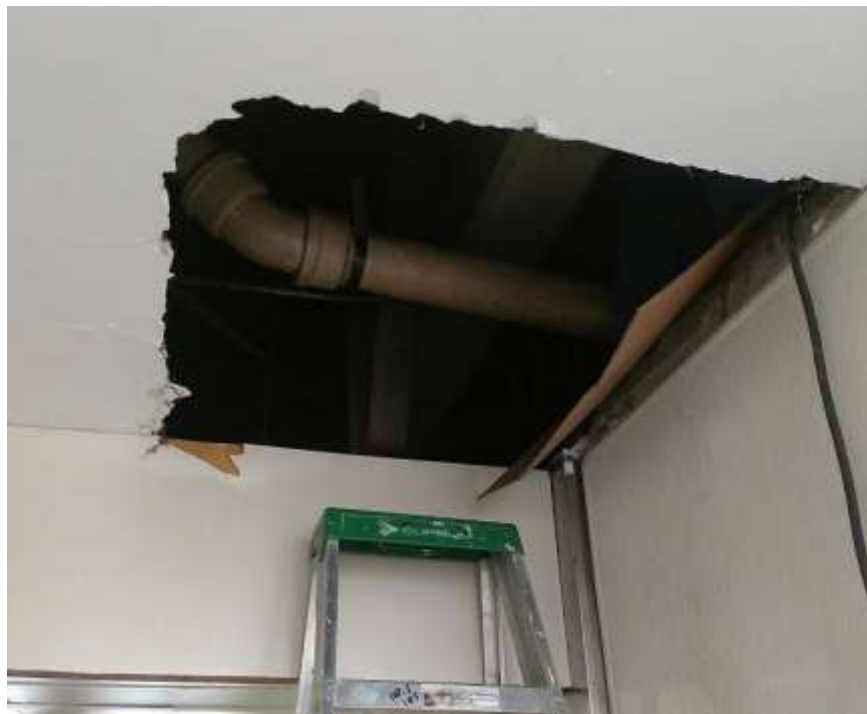
FOTOGRAFÍA 2. TUBERÍA DE HIERRO FUNDIDO DAÑADA POR EL SISMO
