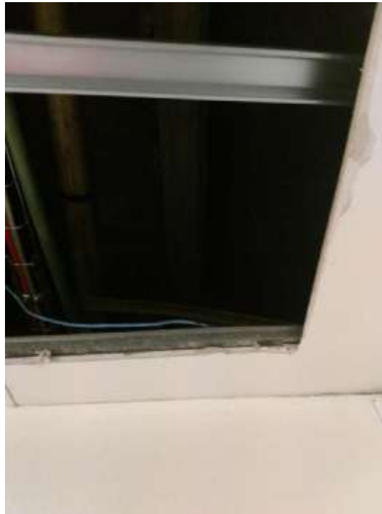
FOTOGRAFÍA 3. TUBERÍA DE HIERRO FUNDIDO DAÑADA POR EL SISMO
