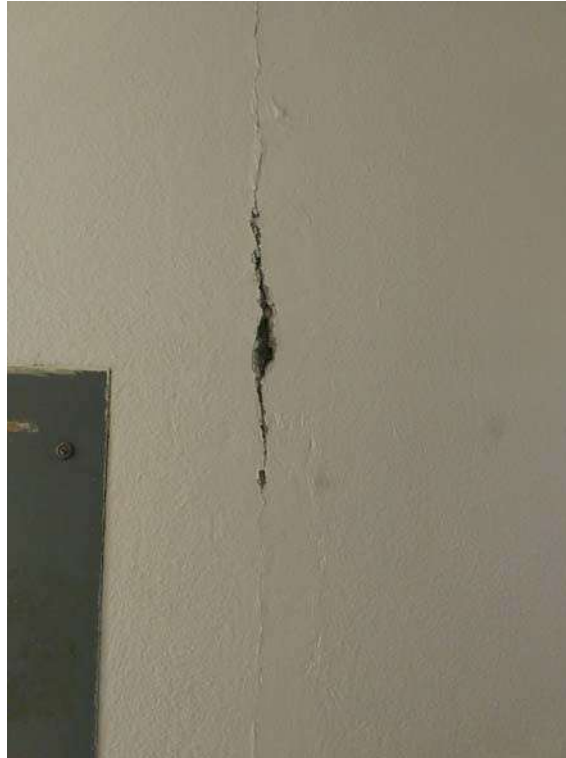
FOTOGRAFÍA 5. GRIETA QUE SE PRESENTÓ EN LA UNIÓN DE UN MURO DE TABIQUE CON UNA COLUMNA DE CONCRETO.
