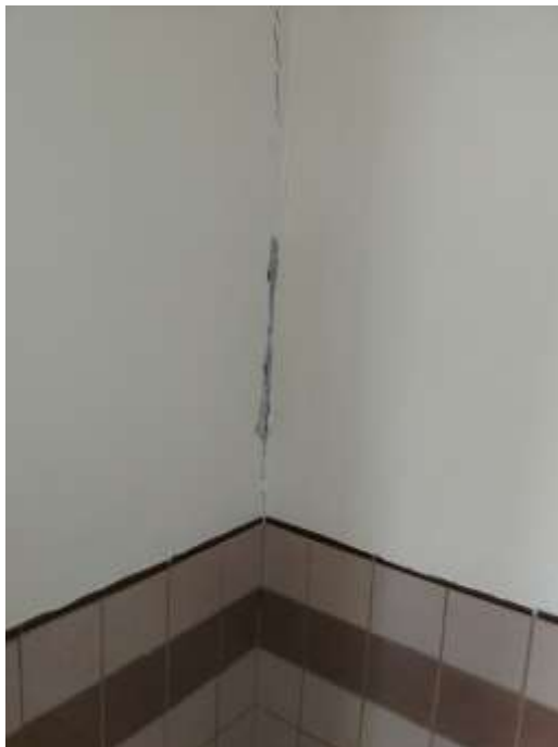
FIG. 6.- GRIETA NO ESTRUCTURAL EN ACABADOS DE MUROS.
