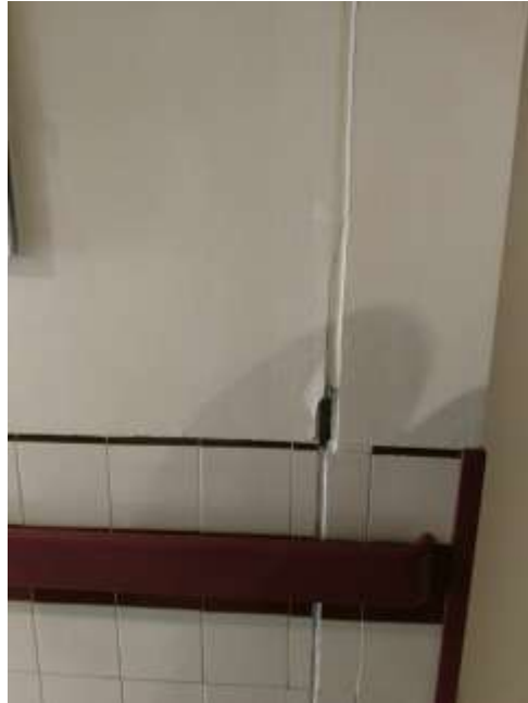
FIG. 5.- DAÑO EN ACABADOS DE MUROS.
