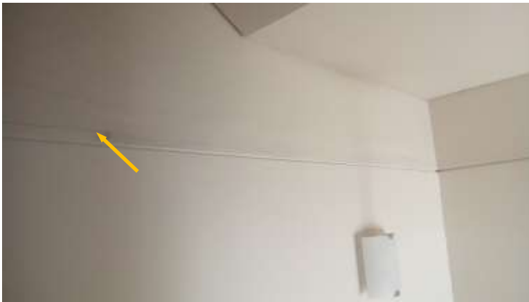
Foto 6. Fisura en Junta Constructiva (canaleta "u" de control recto de pvc para junta de expansión de paneles tablaroca o durock)
