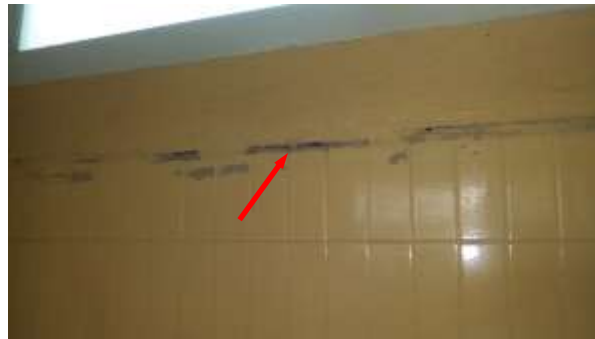
Foto 5. Fisura en la Junta entre cintilla cerámica y aplanado
