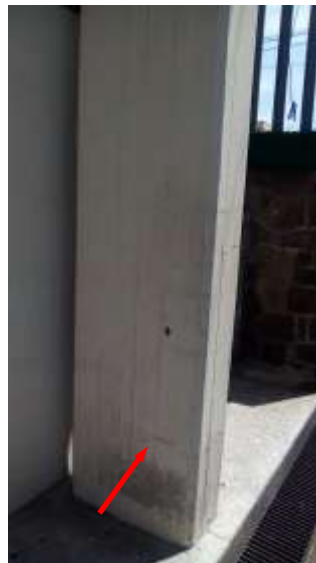
Foto 6. Antiguas Fisuras en el recubrimiento de columnas
