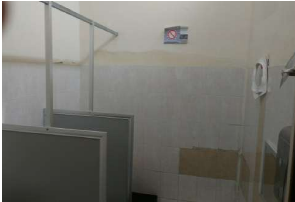
FOTOGRAFIA 8B: ÁREA DE BAÑOS
