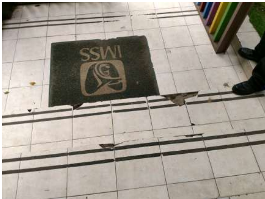
FOTOGRAFIA 19.- DETERIORO EN PISO LAMINADO EN PLANTA BAJA
