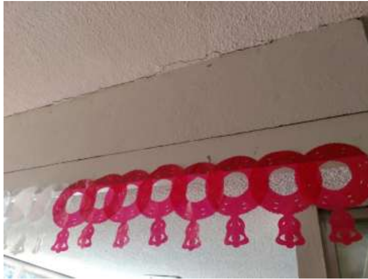
FOTOGRAFIA 25: LIGERO AGRIETAMIENTO DE PLAFÓN Y MURO.
