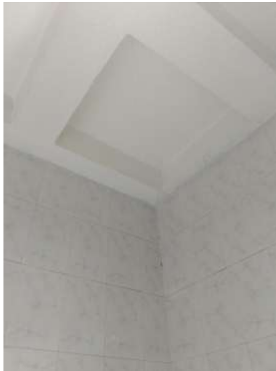
FOTOGRAFIA 26: GRIETA LIGERA EN PLAFÓN.
