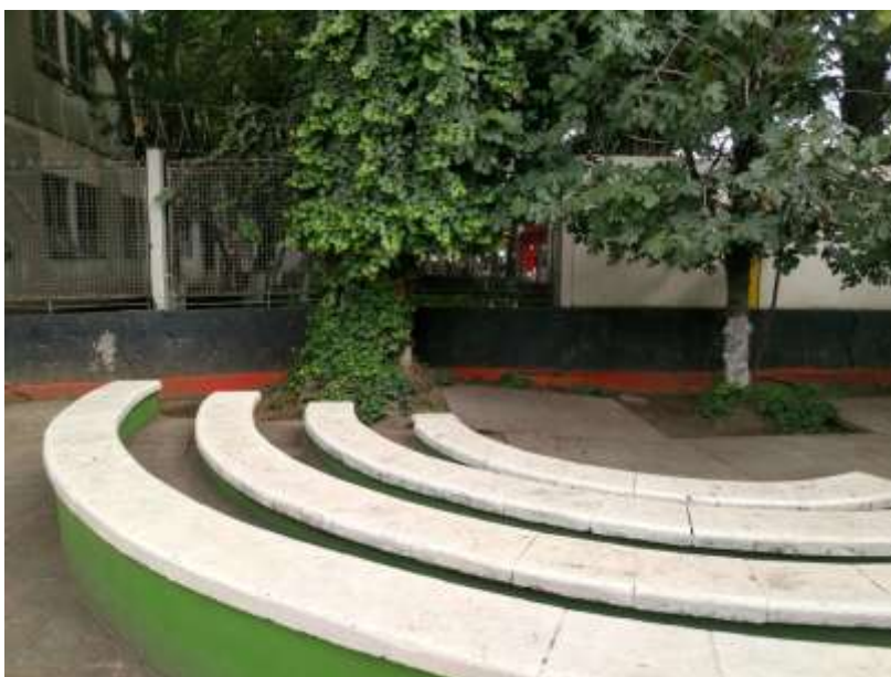
FOTOGRAFIA 5.- SE OBSERVA EL LEVANTAMIENTO DEL PISO DEBIDO AL CRECIMIENTO DE LA RAÍZ DE LOS ÁRBOLES.
