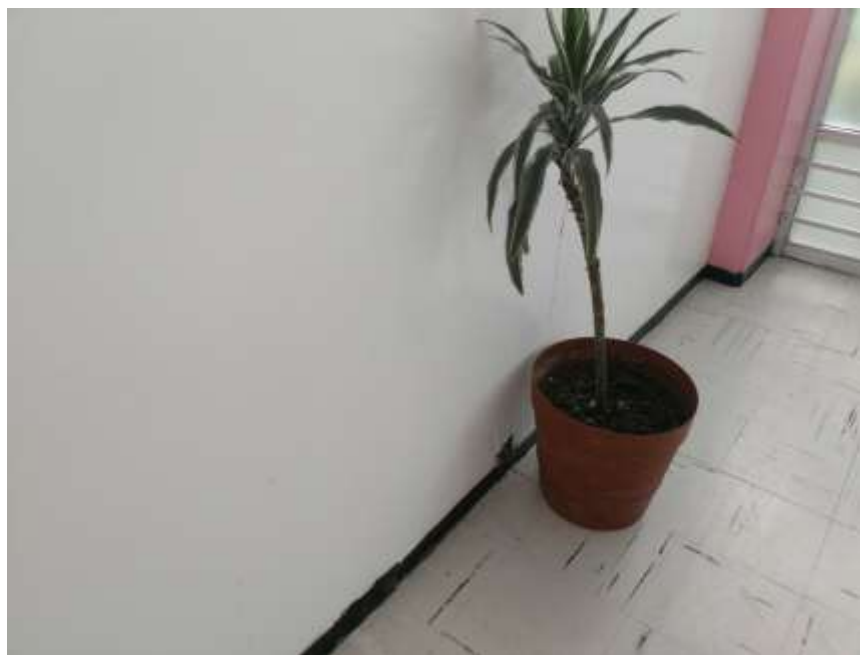
FOTOGRAFIA 17.- GRIETA EN MURO EN PLANTA BAJA
