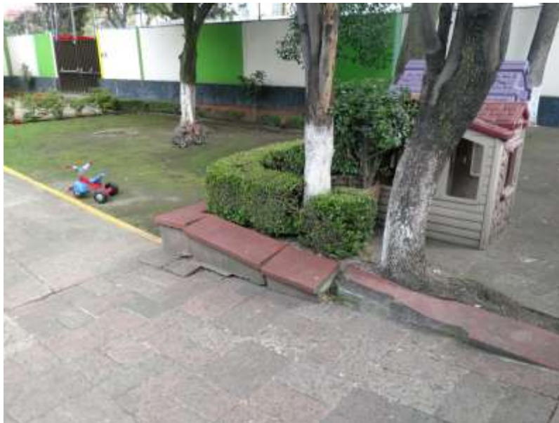
FOTOGRAFIA 4.- SE OBSERVA EL LEVANTAMIENTO DEL PISO DEBIDO AL CRECIMIENTO DE LA RAÍZ DE LOS ÁRBOLES.
