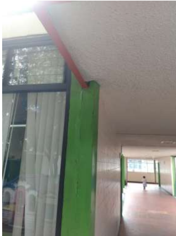
FOTOGRAFIA 7.- GRIETA EN LA UNIÓN DE DOS CUERPOS
