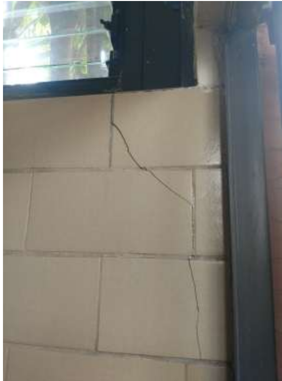
FOTOGRAFIA 11.- GRIETA EN MUROS DE MAMPOSTERÍA EN PLANTA BAJA
