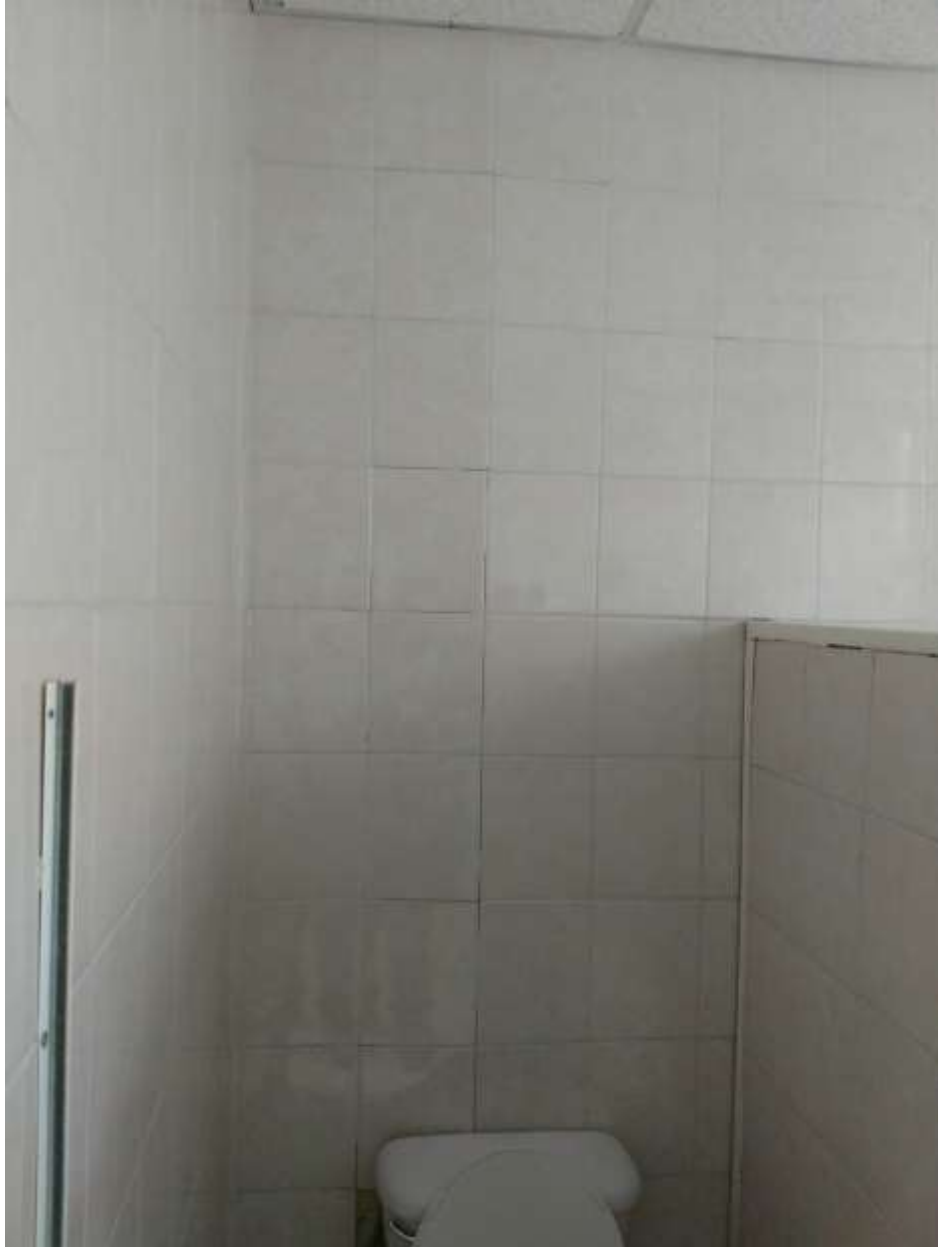
FOTOGRAFIA 24: BAÑOS COMPLETOS Y EN BUEN ESTADO Y FALTA DE SELLADOR EN ALGUNAS PIEZAS DE MOSAICO
