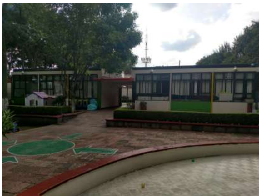
FOTOGRAFIA 6.- SE OBSERVA EL LEVANTAMIENTO DEL PISO DEBIDO AL CRECIMIENTO DE LA RAÍZ DE LOS ÁRBOLES.
