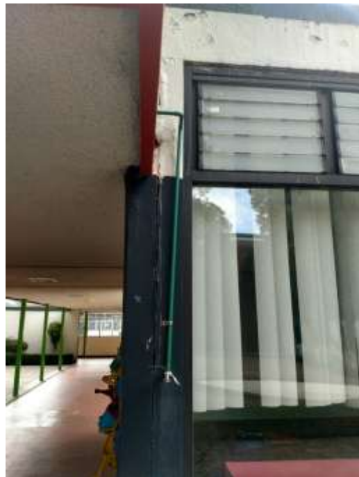
FOTOGRAFIA 8.- GRIETA EN LA UNIÓN DE DOS CUERPOS
