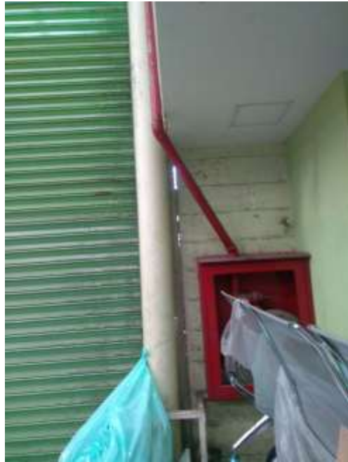
FOTOGRAFÍA 5- SEPARACIÓN DE UNO DE LOS MUROS DE FACHADA DE SU ELEMENTO CONFINANTE
