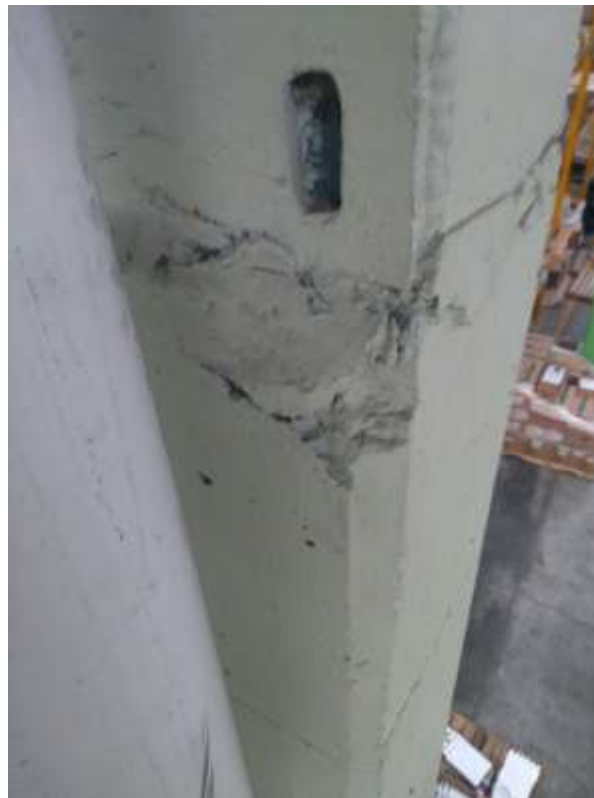
FOTOGRAFÍA 2. – SE OBSERVA UNA MALA EJECUCIÓN EN LOS TRABAJOS CONSTRUCTIVOS
