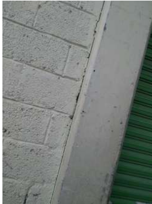
FOTOGRAFÍA 7- SEPARACIÓN DE UNO DE LOS MUROS DE FACHADA DE SU ELEMENTO CONFINANTE
