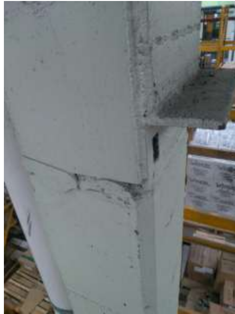
FOTOGRAFÍA 3- SE OBSERVA UNA MALA EJECUCIÓN EN LOS TRABAJOS CONSTRUCTIVOS
