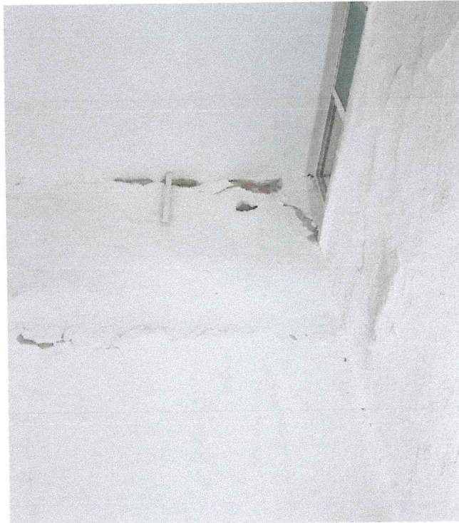
Fisuras en acabados en zona de rampa en acceso a sótano
