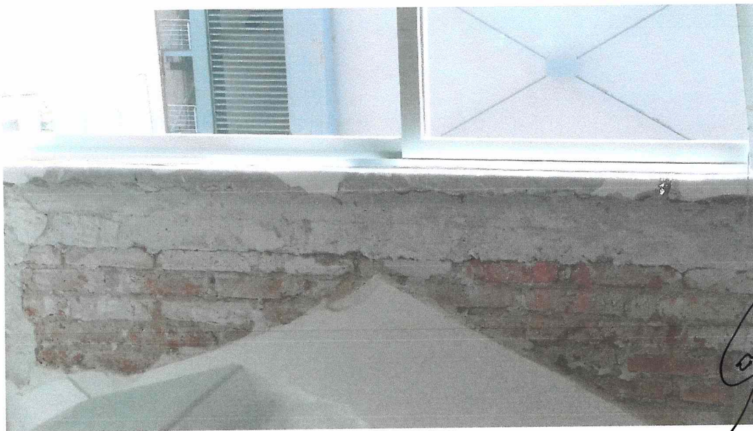
Fisuras en pretilas en primer, segundo y tercer nivel que no representan daño estructural.
