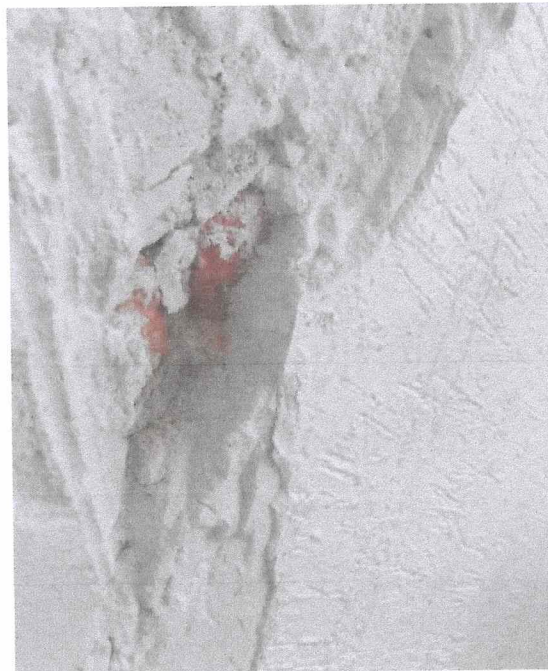
Exceso de espesor en recubrimientos existentes, principal causa de fisuras en muros y elementos estructurales. Se recomienda 1.50 cm de espesor en recubrimientos.
