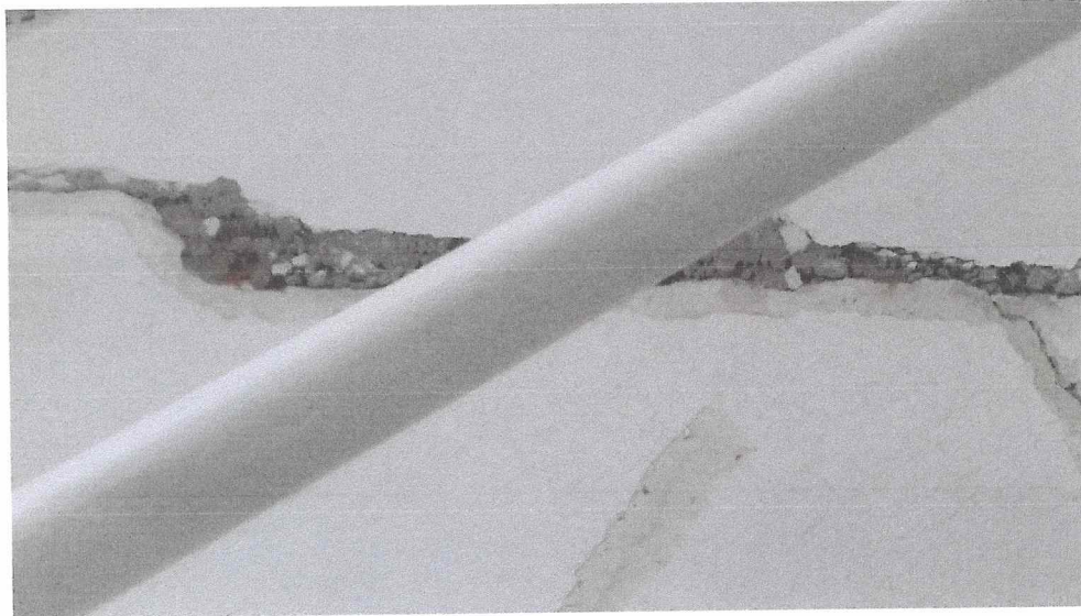
Separación en junta constructiva del cubo de escaleras.
