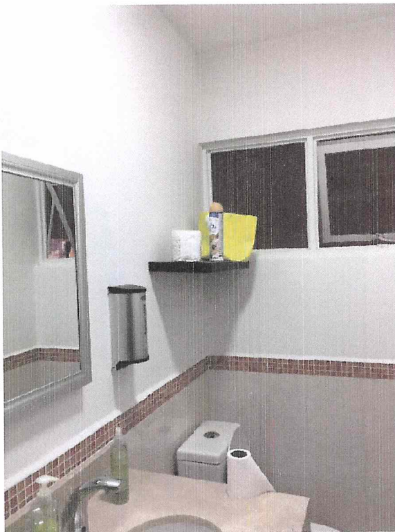
AREAS CON INSTALACIONES HIDROSANITARIAS NO PRESENTAN FUGAS
