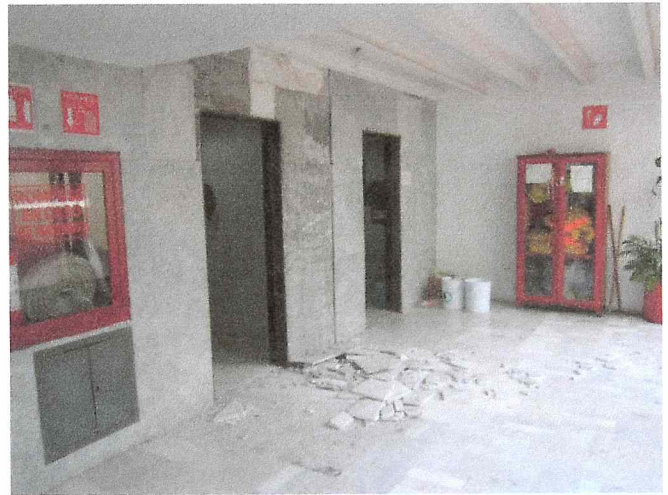
DESPRENDIMIENTO DE ACABADO SIN DAÑO ESTRUCTURAL
