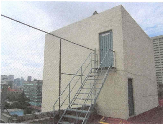
FISURAS SIN DAÑO ESTRUCTURAL
