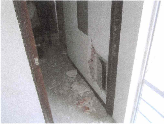
FISURAS SIN DAÑO ESTRUCTURAL
