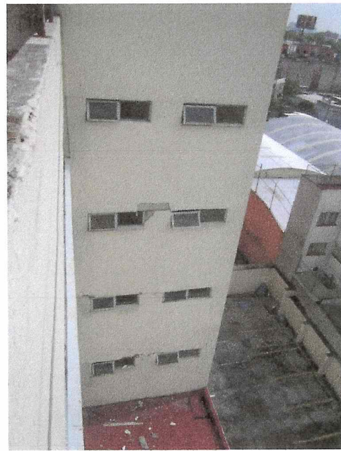
FISURAS SIN DAÑO ESTRUCTURAL
