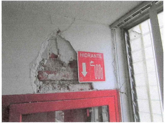
FISURAS SIN DAÑO ESTRUCTURAL
