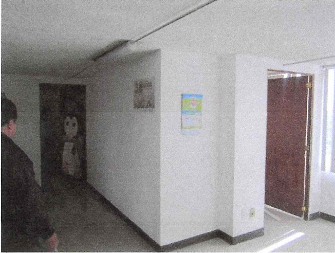
FISURAS SIN DAÑO ESTRUCTURAL
