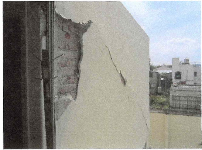
FISURAS CON POSIBLE RIESGO
