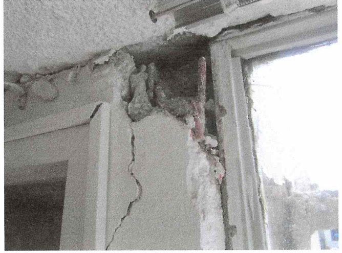
FISURAS CON POSIBLE RIESGO
