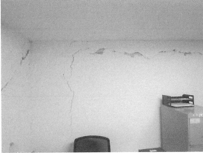
FISURAS CON POSIBLE RIESGO
