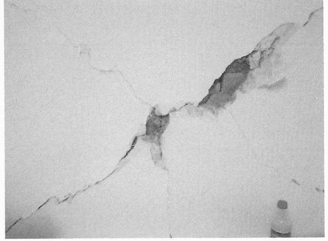
FISURAS CON POSIBLE RIESGO
