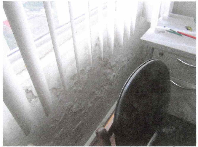
HUMEDAD SIN DAÑO ESTRUCTURAL
