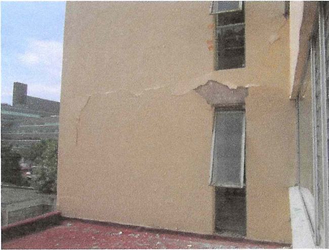
FISURAS CON POSIBLE RIESGO
