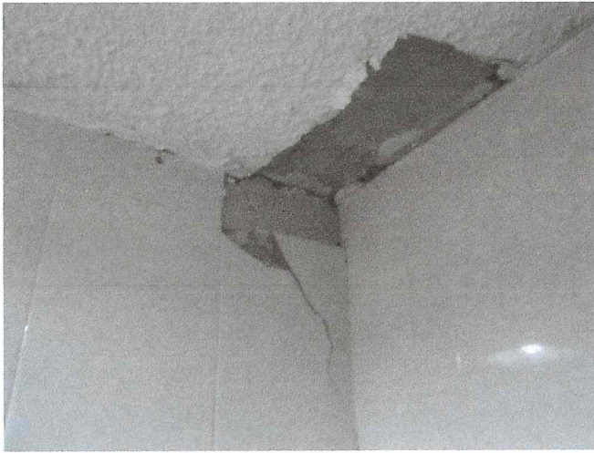
FISURAS SIN DAÑO ESTRUCTURAL
