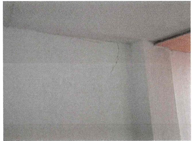
FISURAS SIN DAÑO ESTRUCTURAL
