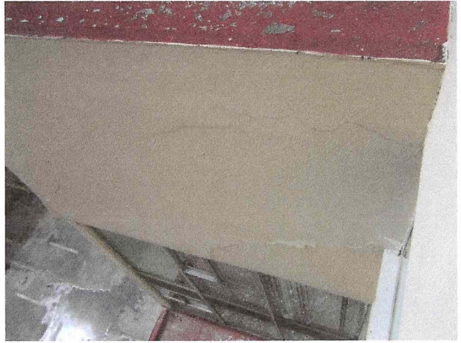
FISURAS CON POSIBLE RIESGO
