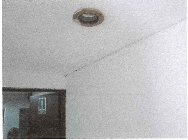
FISURAS SIN DAÑO ESTRUCTURAL
