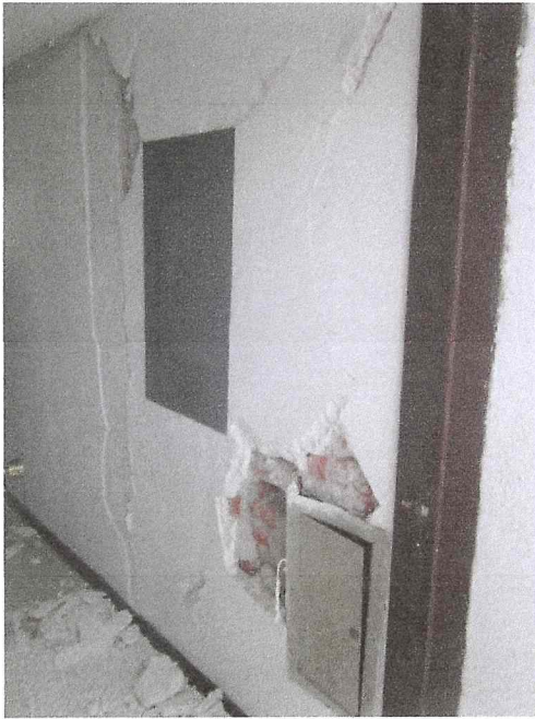
FISURAS SIN DAÑO ESTRUCTURAL
