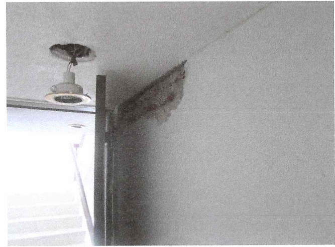
FISURAS SIN DAÑO ESTRUCTURAL
