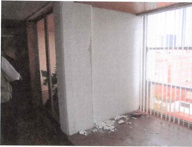
FISURAS SIN DAÑO ESTRUCTURAL
