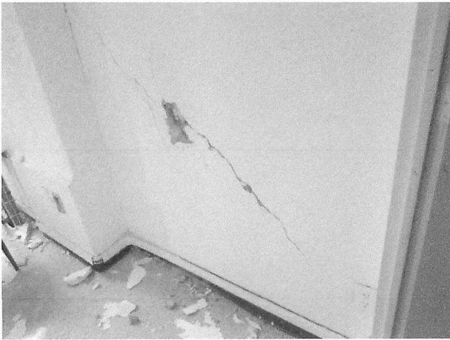
FISURAS SIN DAÑO ESTRUCTURAL
