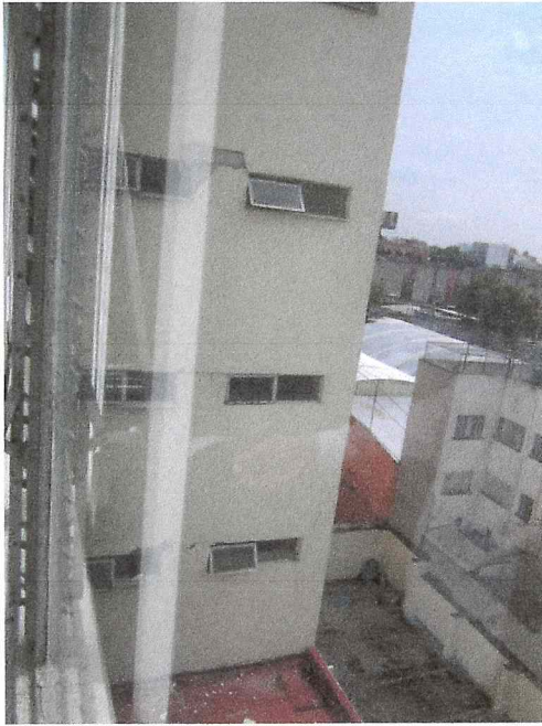
FISURAS SIN DAÑO ESTRUCTURAL
