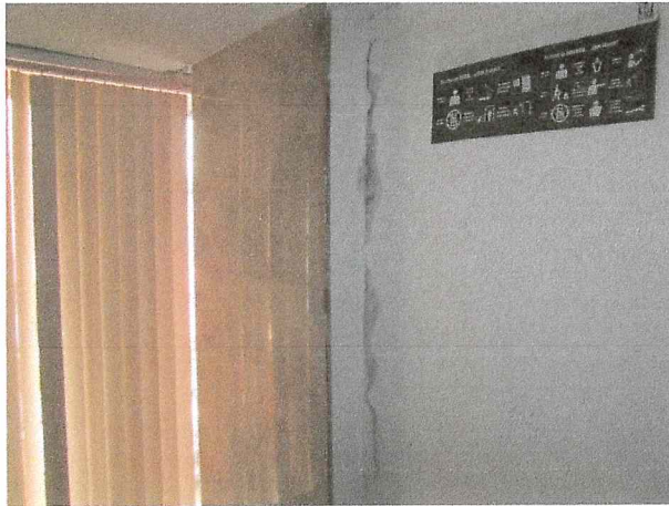
FISURAS SIN DAÑO ESTRUCTURAL
