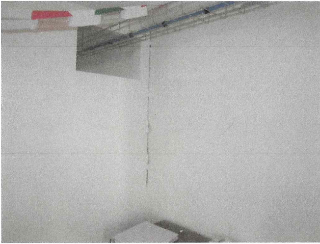
FISURAS SIN DAÑO ESTRUCTURAL
