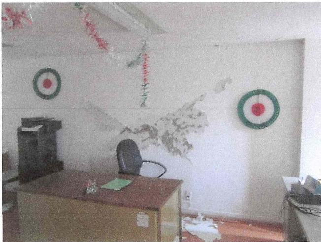
FISURAS SIN DAÑO ESTRUCTURAL
