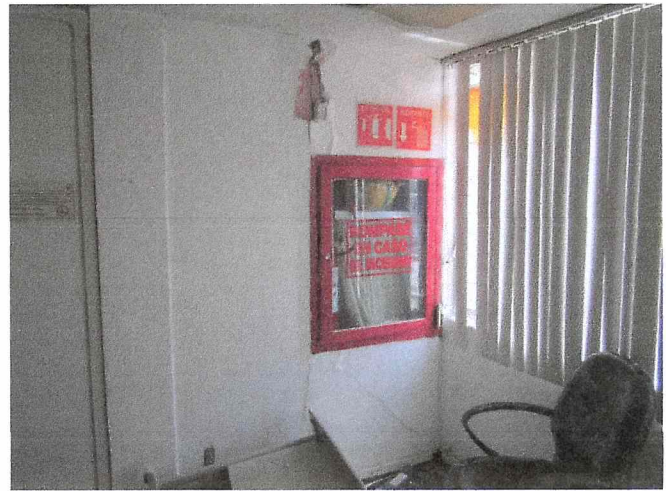
FISURAS SIN DAÑO ESTRUCTURAL
