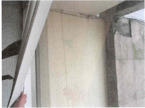
FISURAS SIN DAÑO ESTRUCTURAL
