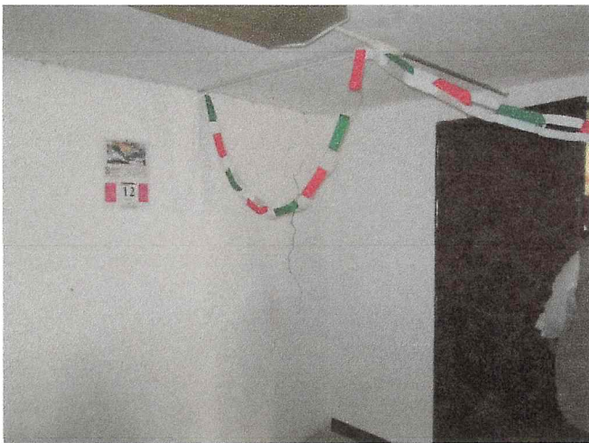
FISURAS SIN DAÑO ESTRUCTURAL
