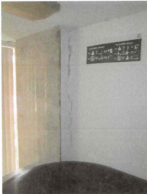
FISURAS SIN DAÑO ESTRUCTURAL
