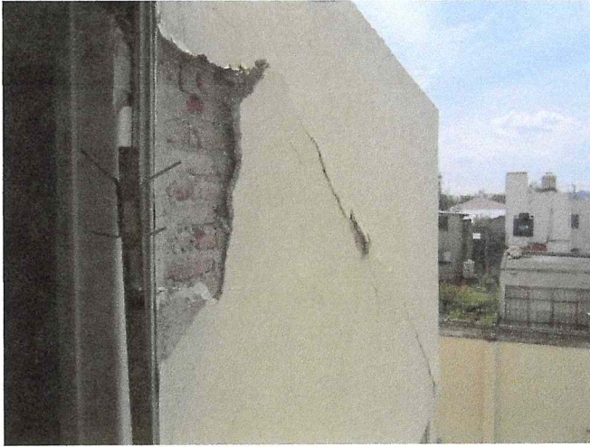
FISURAS CON POSIBLE RIESGO
