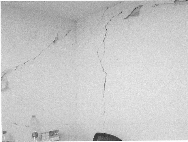
FISURAS CON POSIBLE RIESGO
