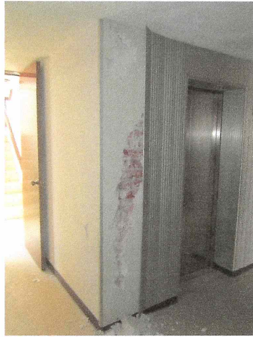
FISURAS SIN DAÑO ESTRUCTURAL
