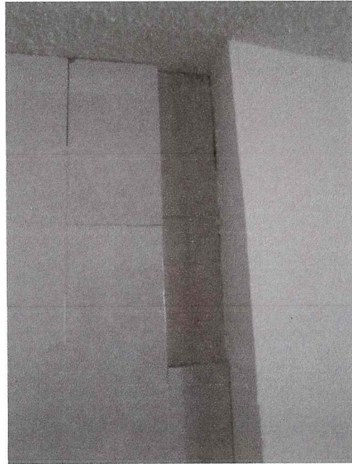
FISURAS SIN DAÑO ESTRUCTURAL
