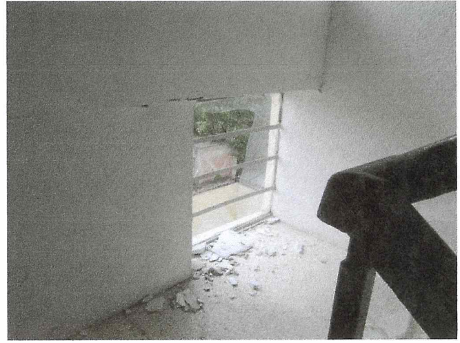
FISURAS SIN DAÑO ESTRUCTURAL
