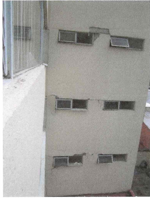
FISURAS SIN DAÑO ESTRUCTURAL
