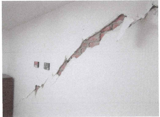
FISURAS CON POSIBLE RIESGO
