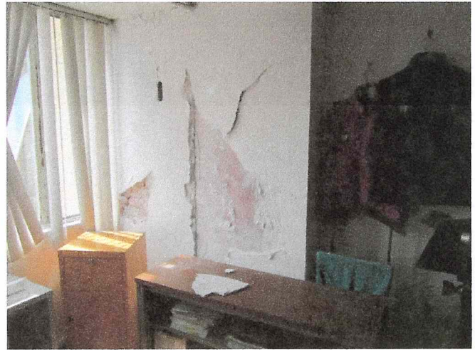
FISURAS SIN DAÑO ESTRUCTURAL
