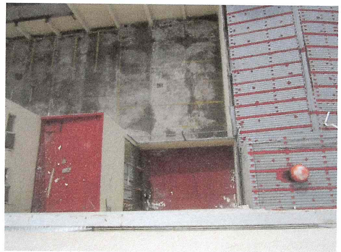
FISURAS SIN DAÑO ESTRUCTURAL
