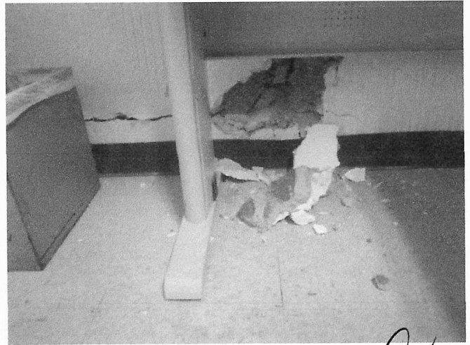
FISURAS CON POSIBLE RIESGO
