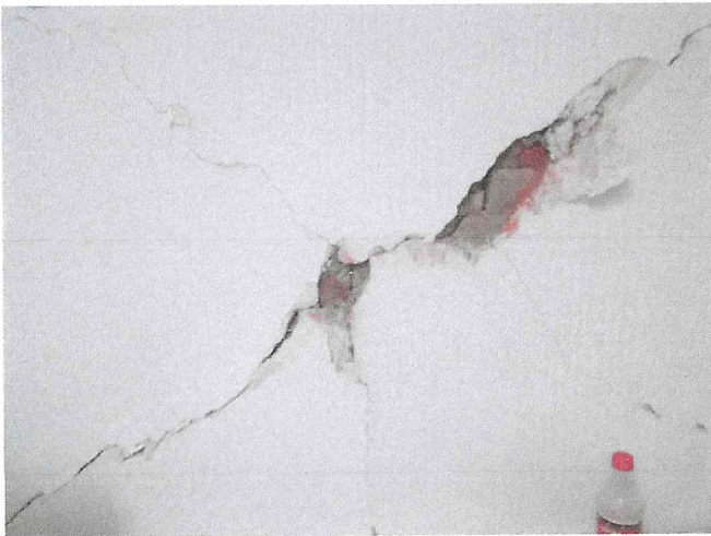
FISURAS CON POSIBLE RIESGO
