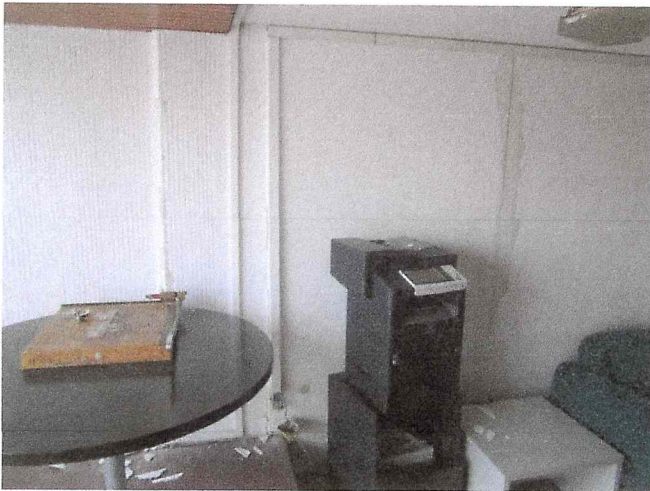
FISURAS SIN DAÑO ESTRUCTURAL
