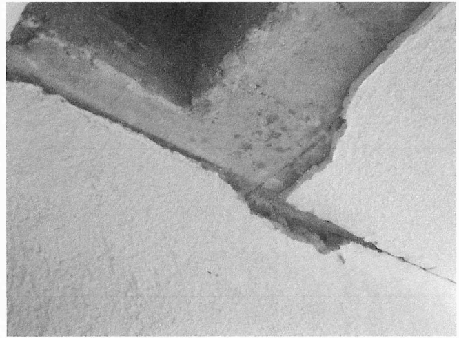
FISURAS SIN DAÑO ESTRUCTURAL
