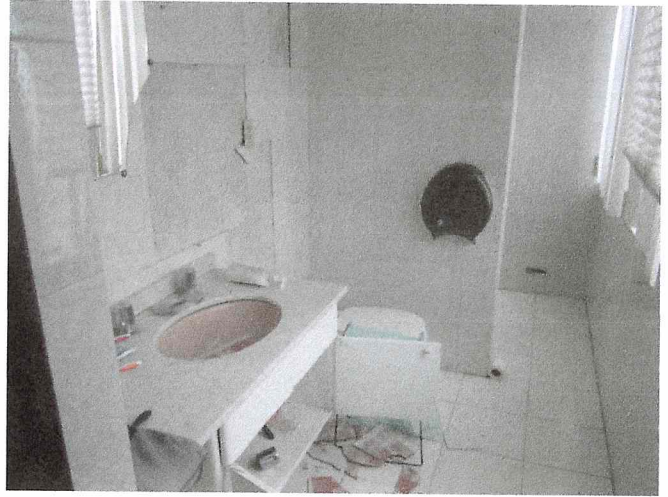
FISURAS SIN DAÑO ESTRUCTURAL
