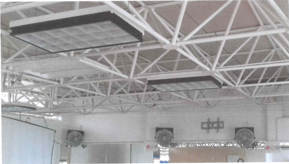
Zona de gimnasio en planta de azotea. Estructura metálica tipo tridilosa apoyada en columnas y muros existentes de concreto.
