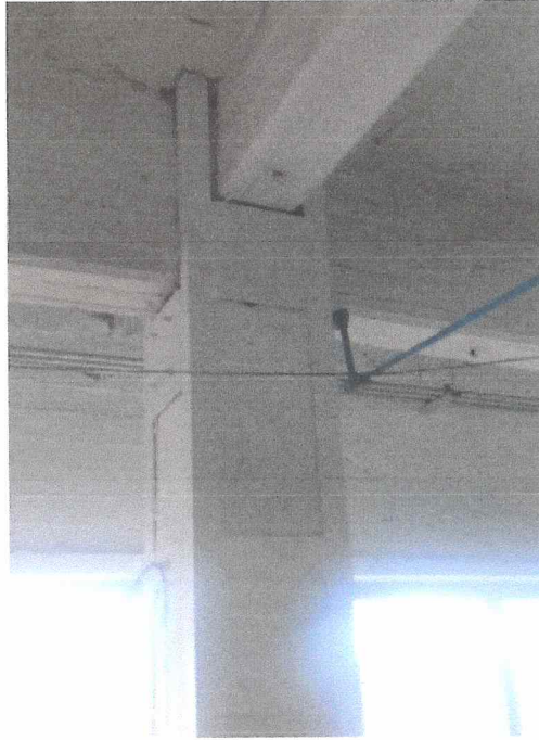
Refuerzo en columna de concreto reforzado de cuarto de máquinas en azotea (después del sismo de 1985).
