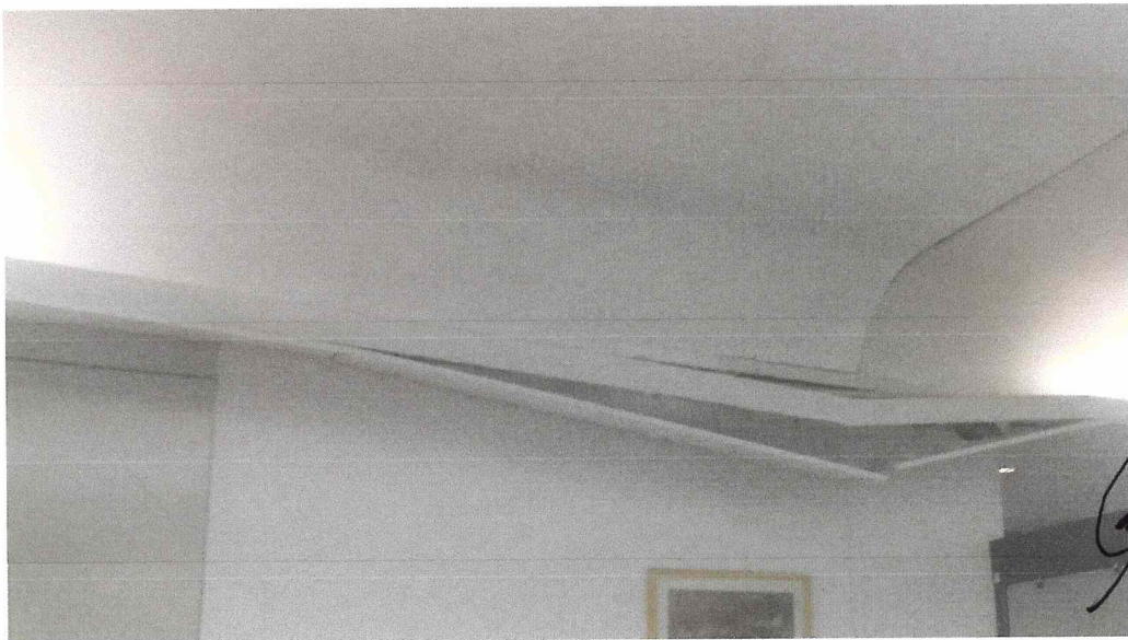
Caída de elementos no estructurales como plafones (tipo) en zona de junta constructiva.
