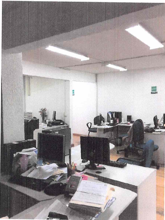
LA ESTRUCTURA DE LAS ZONAS DE TRABAJO SE ENCUENTRAN EN BUEN ESTADO
