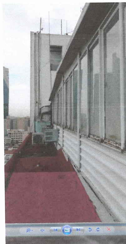
EQUIPOS DE AIRE EN AZOTEA
