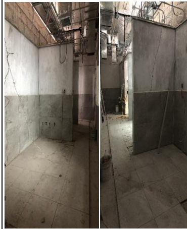
Colocación de loseta cerámica en pisos del área de vestibulo principal , sala de espera y área de entregas
