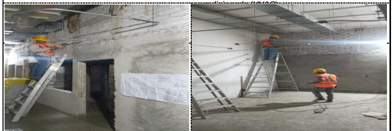
Instalaciones eléctricas de alumbrado., instalación de tubería conduit galvanizada pared gruesa de 19 mm.
