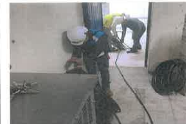
CABLEADO DE ALIMENTADOR ELÉCTRICO CÉDULA 53
