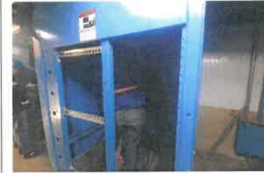
PEINADO DE CIRCUITOS DERIVADOS DEL TABLERO TGN-
