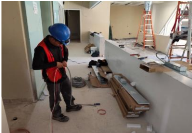
Cableado de lamparas en laboratorio.
