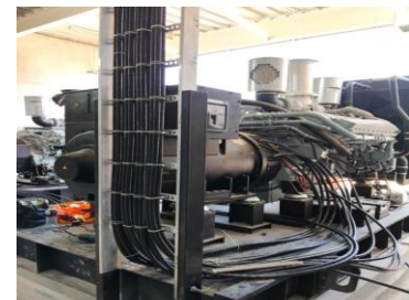
Cableado de planta de emergencia.
