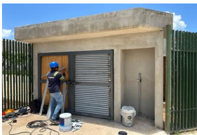
Herreria en puertas de caseta de medición.
