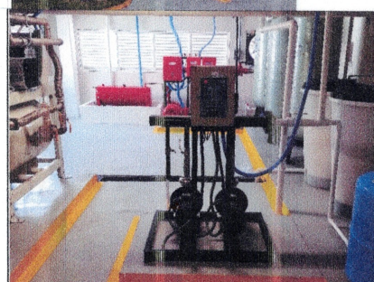
Cuarto de Maquinas
