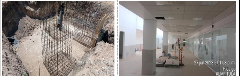
ARMADO Y COLOCACION DE ACERO DE REFUERZO EN BY PASS DE BIODIGESTOR
