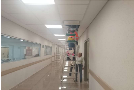
Revisión de trampas de vapor.
