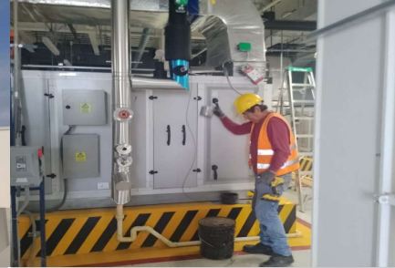
Instalación de BMS en equipos de HVAC
