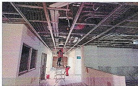
SEÑALIZACIÓN DE TUBERÍAS EN PASILLOS DE URGENCIAS, EDIFICIO 5 PLANTA BAJA
