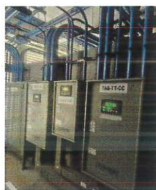
Señalizacion de equipos en subestacion principal
