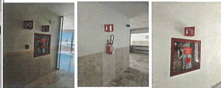
SEÑALIZACIONES PARA EQUIPOS CONTRA INCENDIO
