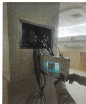
Conexión de Alarma Maestra de Gases Medicinales
