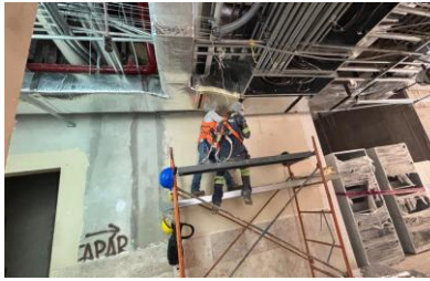
Forrado de ductos de A.A.
