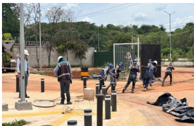
Cableado de acometida eléctrica
