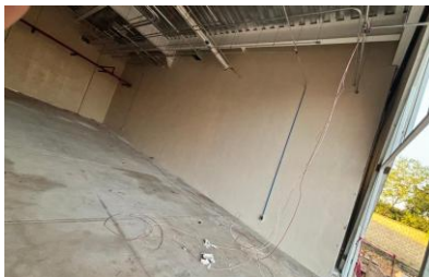
Cableado de contactos en área disponible casa de máquinas.
