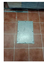
REPARACION DE CERAMICA QUEBRADA CERCA DE TAPA DE LA TRAMPA DE GRASA
