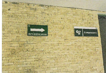
SEÑALIZACION CASA DE GASES MEDICINALES
