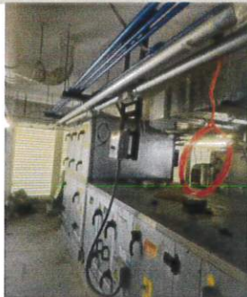
trabajos de automatizacion en equipos de HVAC
