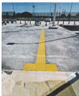
Inst. de Piso podotactil
