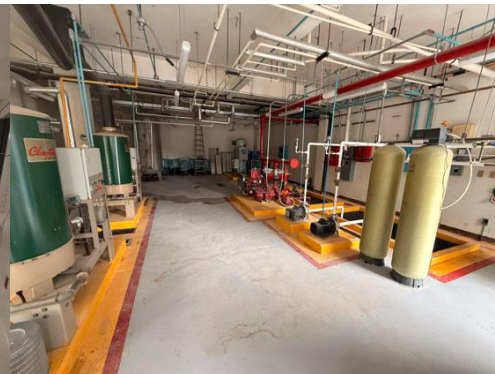
CUARTO DE EQUIPOS HIRÁULICO
