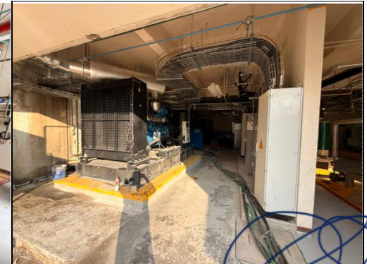
CUARTO DE EQUIPOS ELÉCTRICO
