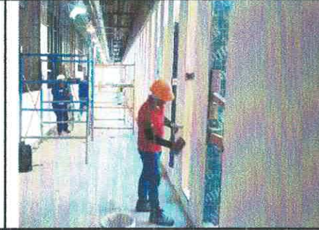
PASTA EN MUROS PB EDIF. "A"
