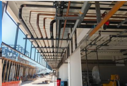
Instalación hidráulica de Cuerpo Casa de Máquinas
