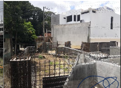
TAPIAL EN MAL ESTADO
