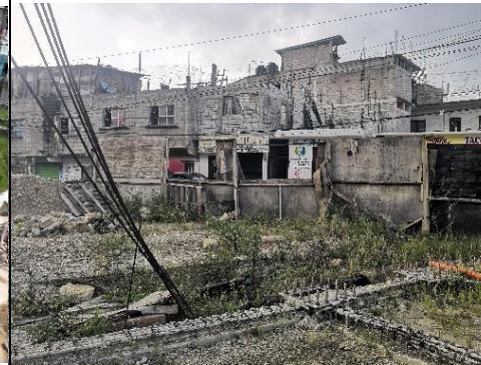
TAPIAL EN MAL ESTADO
