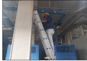
INSPECCIÓN FÍSICA Y TÉCNICA DE TRAYECTORIAS DE CCTV AL INTERIOR DE LA NUEVA CENTRAL DE SERVICIOS.
