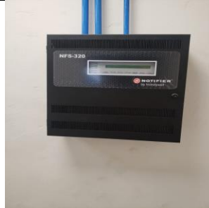
control inteligente contra incendio
