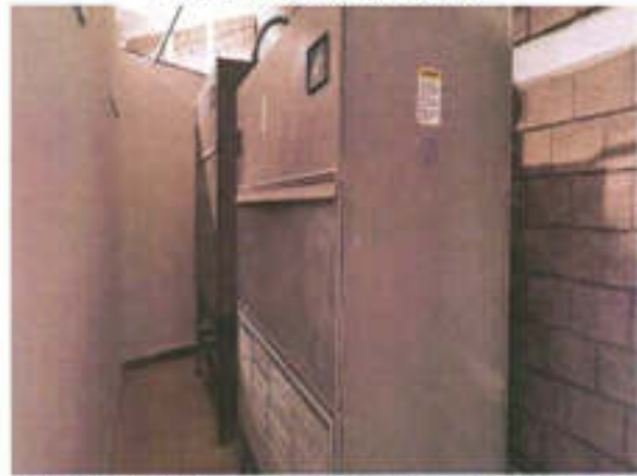
Vista interior del activo en estudio (equipos de aire acondicionado)
