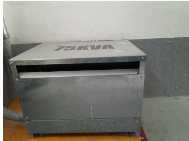
VISTA DE TRANSFORMADOR
