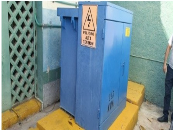
VISTA DE TRANSFORMADOR
