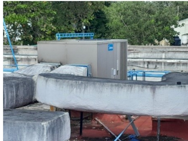
VISTA UNIDAD DE PAQUETE AIRE ACONDICIONADO
