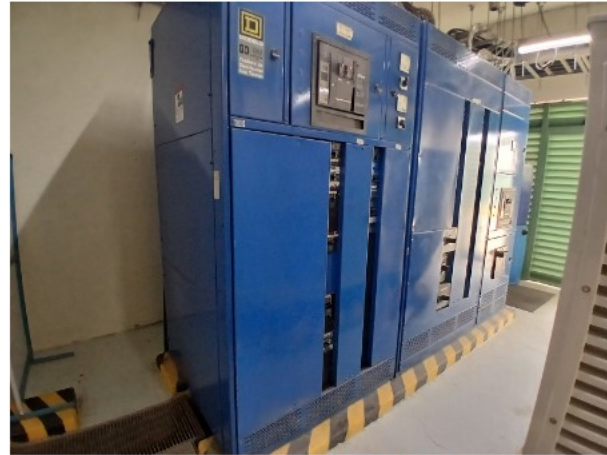
PLANTA DE EMERGENCIA
