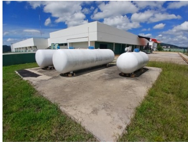
TANQUES DE ALMACENAMIENTO
