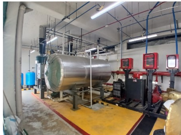
SISTEMA DE BOMBEO CONTRA INCENDIOS
