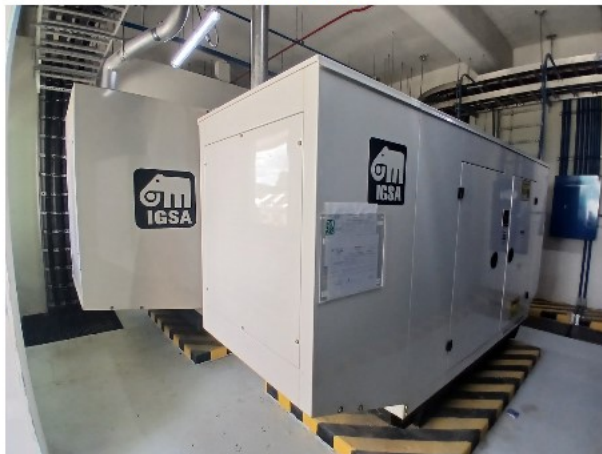
PLANTA DE EMERGENCIA
