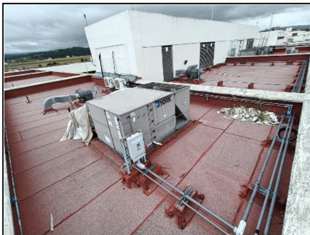
CUARTO DE AIRE ACONDICIONADO
