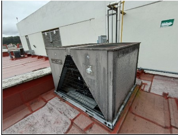
EQUIPO DE AIREA ACONDICIONADO
