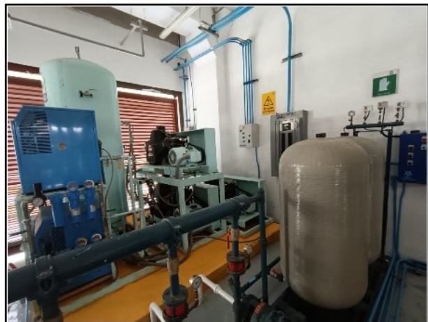
CUARTO DE MÁQUINAS
