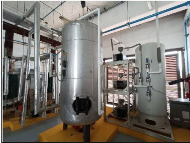
CUARTO DE MÁQUINAS
