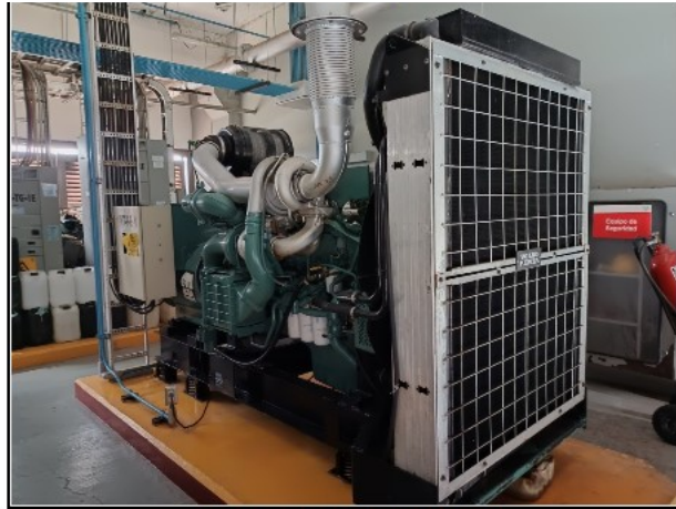
PLANTA DE EMERGENCIA
