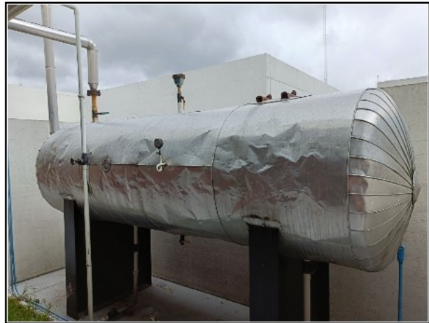
TANQUE DE PRECALENTAMIENTO
