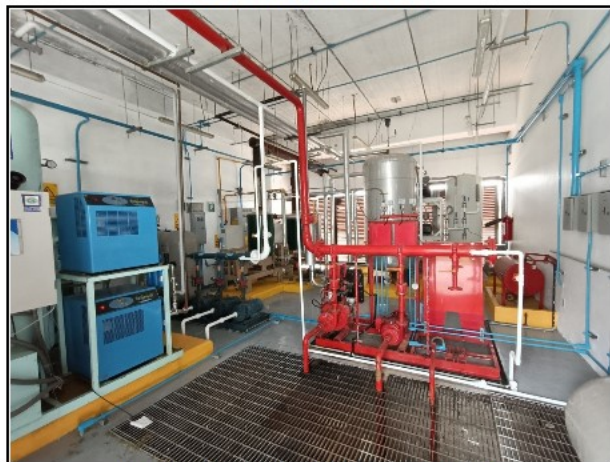
ÁREA DE EQUIPO CONTRA INCENDIO
