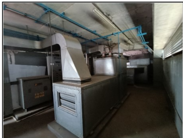
EQUIPO DE AIRE ACONDICIONADO UMAS 7.5 H.P.
