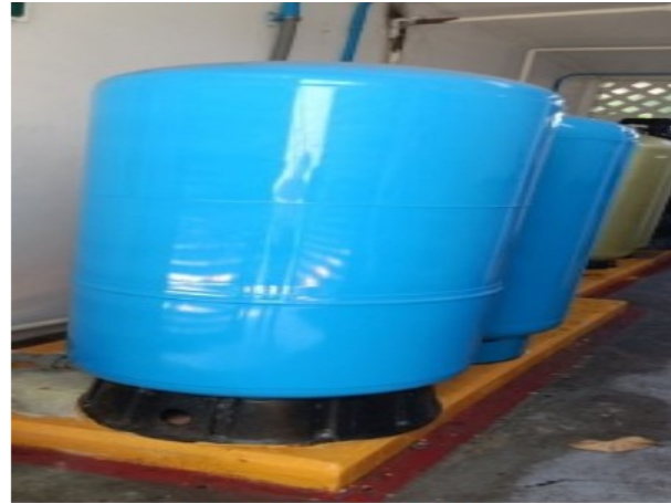
VISTA DE SUAVIZADORES
