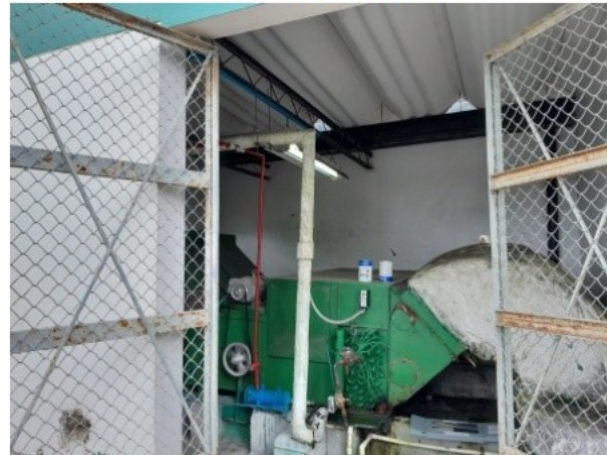
VISTA UNIDAD DE PAQUETE AIRE ACONDICIONADO
