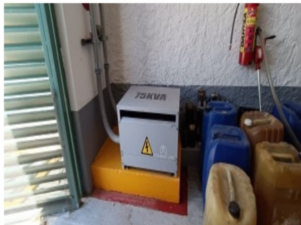
VISTA DE TRANSFORMADOR
