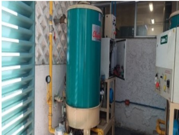
VISTA DE HIDRONEUMÁTICOS
