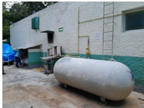
VISTA TANQUE DE GAS
